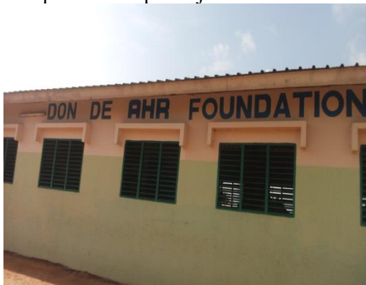
Photo 2 .État de salle de classes en matériaux à l'EPP d'Atrokpocodji
