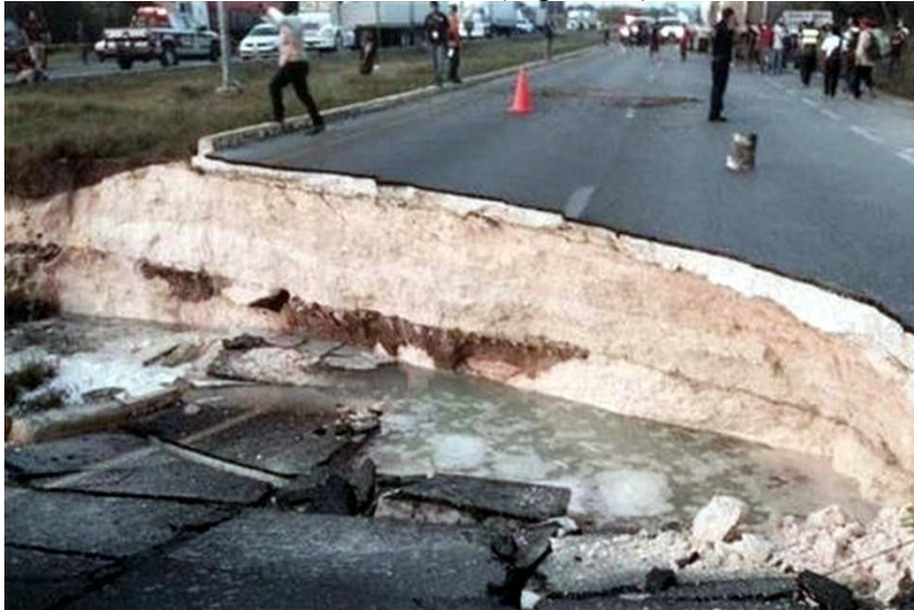
Figura 11. Carreteras destruidas. Hundimiento con exposición del manto freático en el norte de Quintana Roo. Los costos por afectaciones son de millones de pesos.
