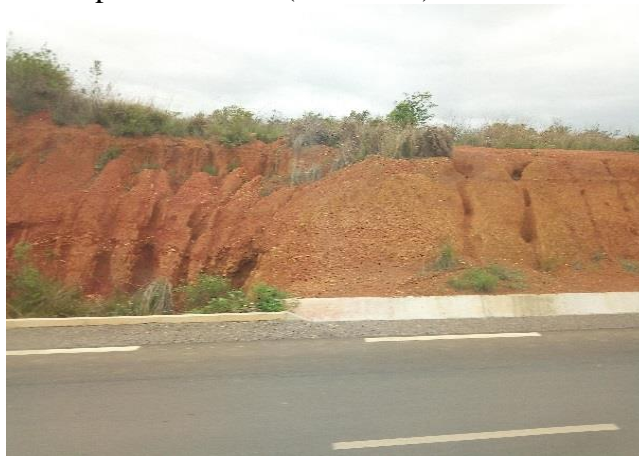
Photo 13: Exemple d'un talus abrupt de 5 m de dénivellation affecté par le processus de l'érosion en ravine qui menace la route On observe la présence des griffures verticales évoluant dans le même sens que la pente du versant (Cliché, B.Mayima, 2017)
