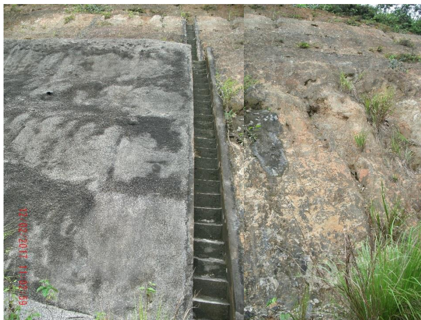
Photo 8 : Un talus stabilisé par l'association de deux méthodes : méthode mécanique et méthode biologique. A gauche, le talus est stabilisé par la méthode de crépissage ou béton projeté très stable. En revanche, à droite, sur le même talus, on observe la présence des microreliefs et rigoles et quelques plants de vétiver ayant résisté à cette dynamique.
