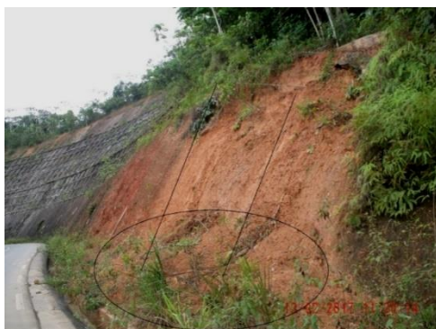
Photo 11 : Glissement de terrain dans le Mayombe
