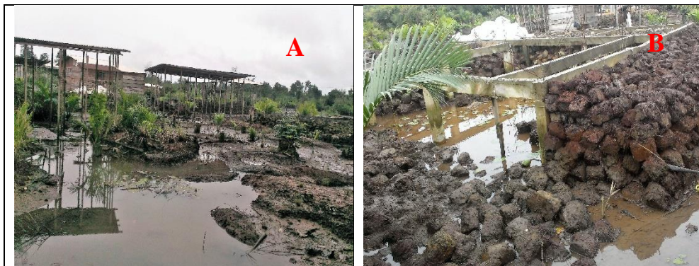
Figure 4 : Initiatives de construction sur le sol instable de Nsong Ngongang, (Clichés, Safougne, mai 2015)
