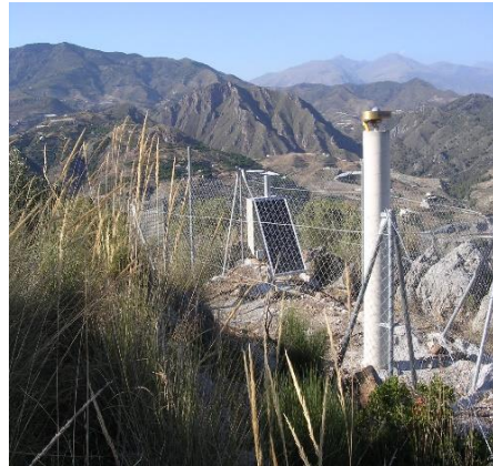
Figura 10. Estación GPS permanente PALM en Sierra de los Guájares, Granada. Se distingue el panel solar junto al armario que contiene el receptor y baterías
