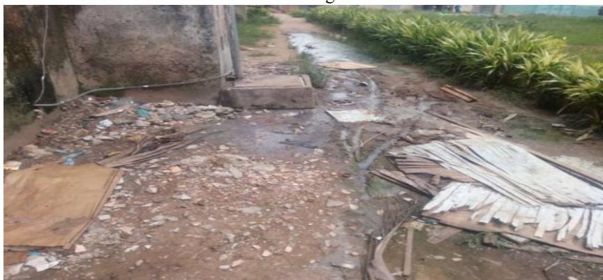
Photo 1 : Débordement d'un regard à Abobo SOGEFIHA
