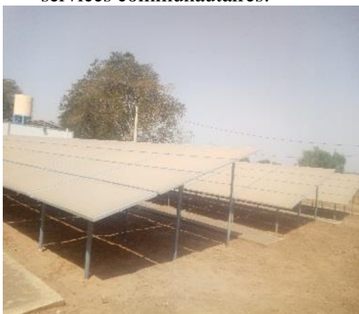
Photo a : champ solaire à Kandi
