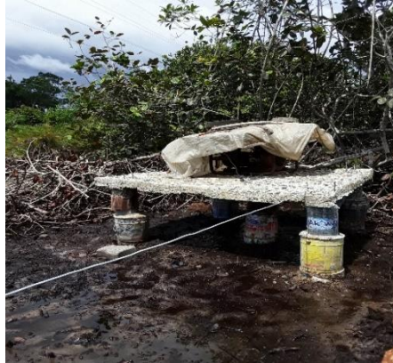
Photo 13 : Un groupe électrogène dans la mangrove à Angondjé-Village Source : LAGRAC., 2020
