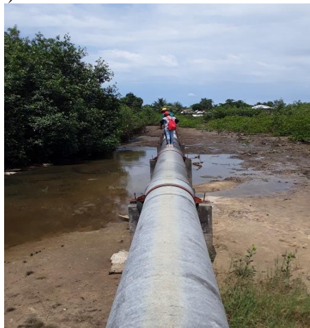
Photo 8 : Canalisation du réseau de distribution d'eau de la SEEG à Okala et Angondjé Source : LAGRAC., 2020
