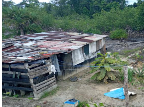
Photo 5 : Une bâtisse en bois délabrée dans les mangroves à Angondjé-Village Source : LAGRAC., 2020
