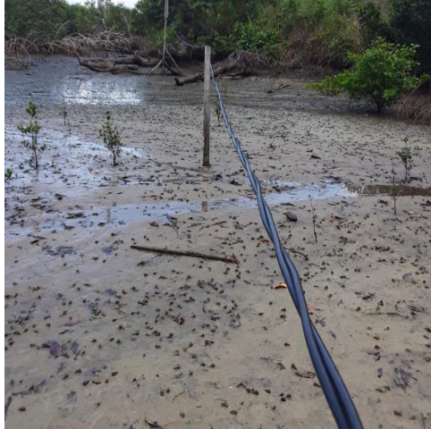
Photo 7 : Câbles électriques traversant une aire de mangrove dévastée à Angondjé Source : LAGRAC., 2020
