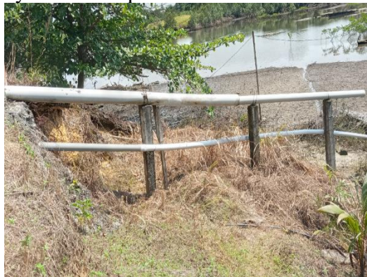
Photo 14 : Tuyaux en PVC d'évacuation des eaux usées à Okala Source : LAGRAC., 2020
