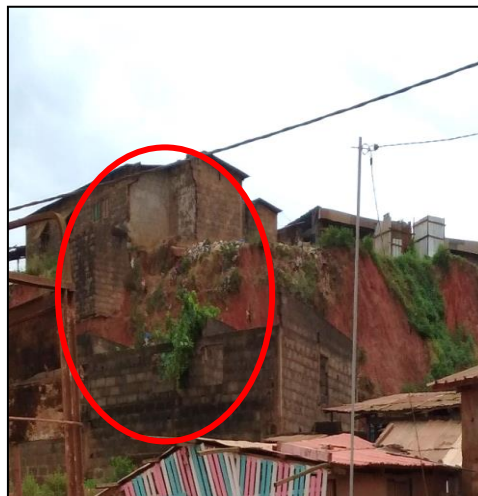
Photo 1a : Impact de l’érosion sur un bâti au quartier SOTREF
