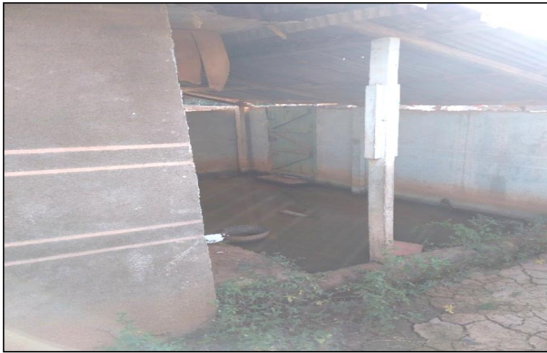
Photo 1b. Impact des inondations au quartier Sonuko-Lac
