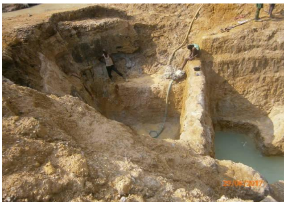
Photo 17. Perturbation des eaux souterraines
