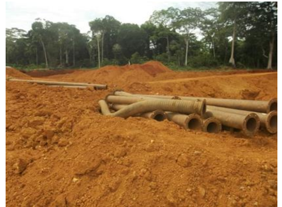
Photo 22. Présence des tuyaux sur les sites (Maud 1)
