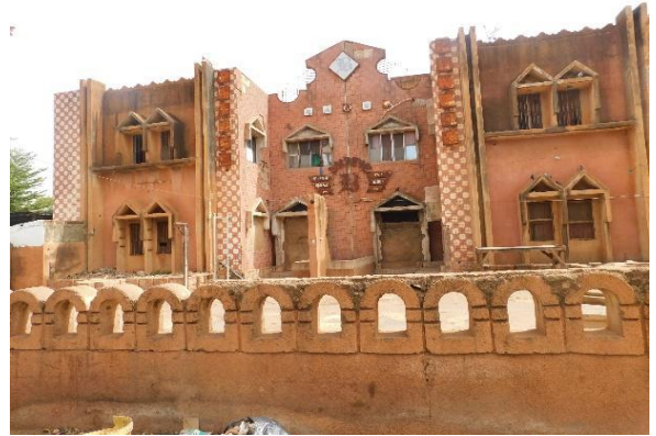
Photo 4. Une salle privée « Ciné Club » à Faladié en état de dégradation car fermée depuis environ 20 ans.
