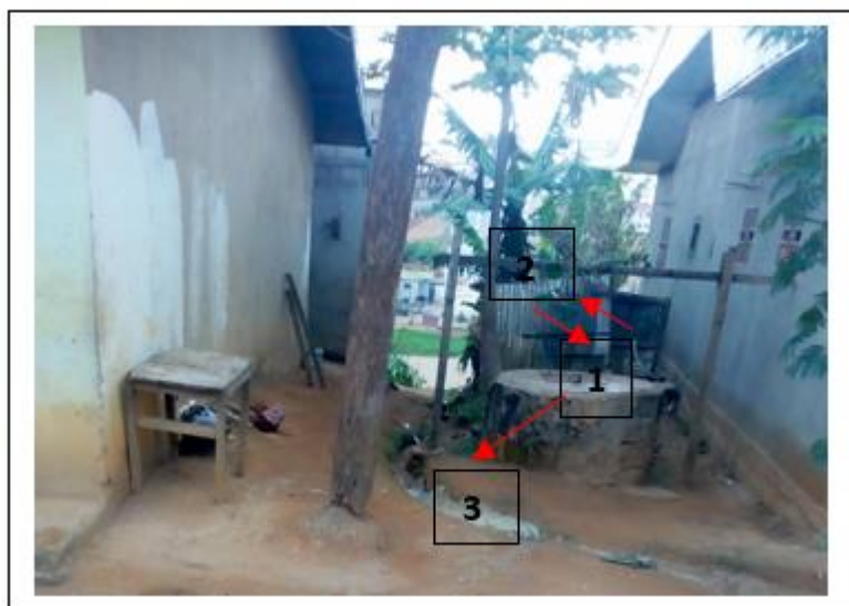
Photo 1 . Puits semi- aménagé situé à moins d'un mètre d'une latrine traditionnelle à fond perdu.
