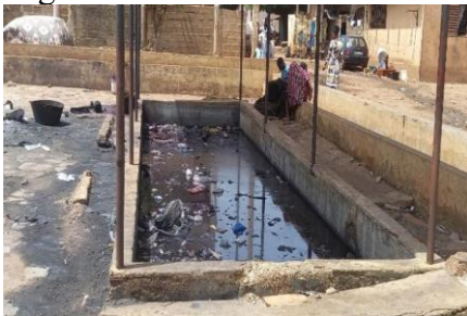
Photo 4 : Etat d'une fosse de traitement
