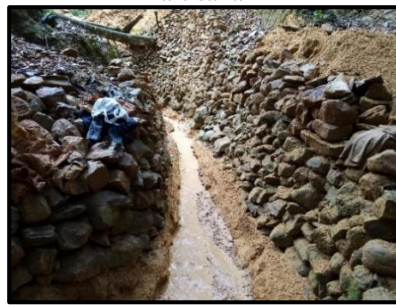
Photo 12 : Mur de soutènement des berges dans un site éluvionnaire (piémont) ou alluvionnaire
