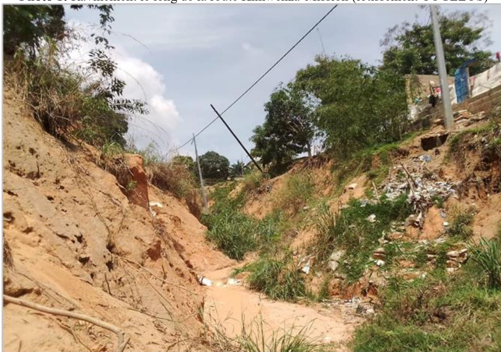
Photo 1 : Ravinement le long de la route Kimwenza-Mission (lotissement COGELOS)
