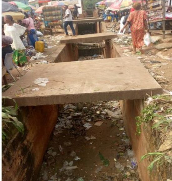
Figure 16: Le collecteur de la route de Kanzombi à proximité du pont Kwilu
