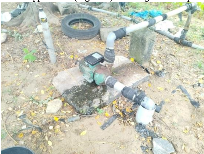
Figure 5 : Supprimeur reliée au forage par les tuyaux PVC
