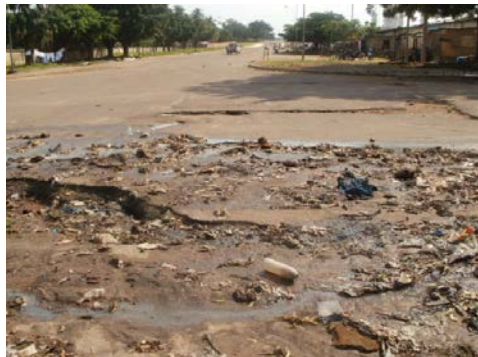
Photo 2 : Dégradation du bitume sous l'action des eaux usées domestiques à Dioulakro Niveau de vie et préoccupations environnementales
