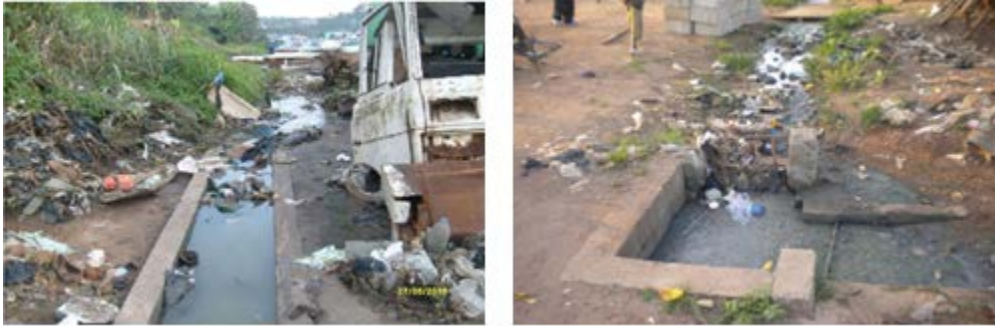
Photo 9 : Caniveaux à ciel ouvert bouchés par les déchets dont les sachets plastiques
