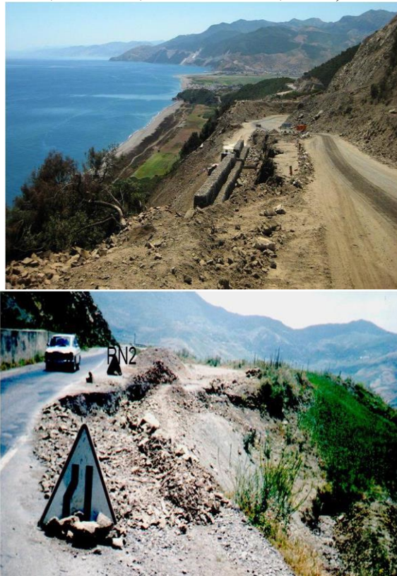
Figure 1 : Dégradation des routes marocaines à cause des instabilités de terrain
